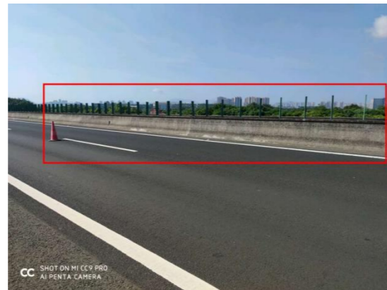
图 3-21 书厅高架桥(上行) HL-L-1 左侧护栏: 胀裂剥落; 数量: 61 处, 长度: 0.3m。
