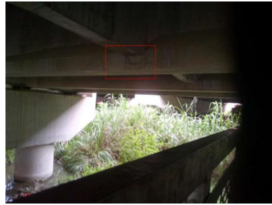
图 3-7: 后眷 2#大桥 (上行) 左幅 1-1T 梁: 距 0 号台 0.5m 起, 右侧, 翼板与腹板交接处网状裂缝; 数量: 1 处, 面积: 0.4m 2 , 宽度: 0.1mm。
