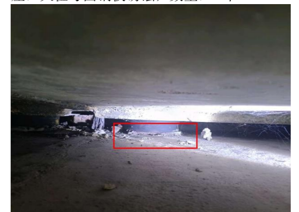
图 3-18: 和溪互通立交 1#桥 (上行) 左幅 ZZ-1-0-31 支座: 大桩号面脱空; 数量: 1 个, 高度: 0.01m, 百分比: 1%。
