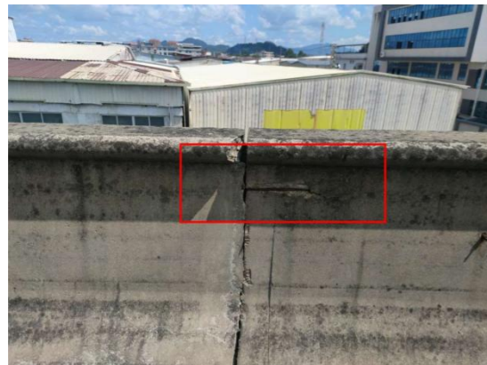
图 3-20 翁建高架桥(上行) HL-L-1 栏杆、护栏: 左侧, 护栏露筋; 数量: 1 处, 长度: 0.7m。
