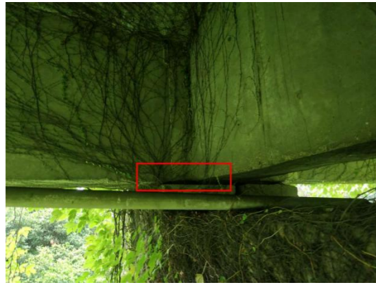
图 3-19: 江东互通主线桥(上行) ZZ-9-9-5 支座: 支座串动; 数量: 1 个, 位移: 0.05m。
