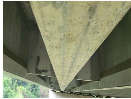
图 3-8: 联桥 3#大桥 (下行) 13-7T 梁: 距 12 号墩 12m 处, 梁底蜂窝、麻面; 数量: 1 处, 长度: 4m, 宽度: 0.5m。
