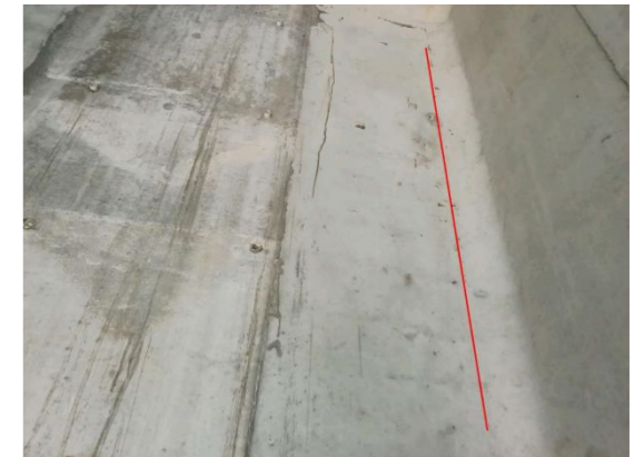
图 3-4: 和溪互通主线 1#桥(下行) 13-7-3H 上部一般构件: 小桩号面竖向裂缝; 数量: 1 条, 长度: 2m, 宽度: 0.15mm。
