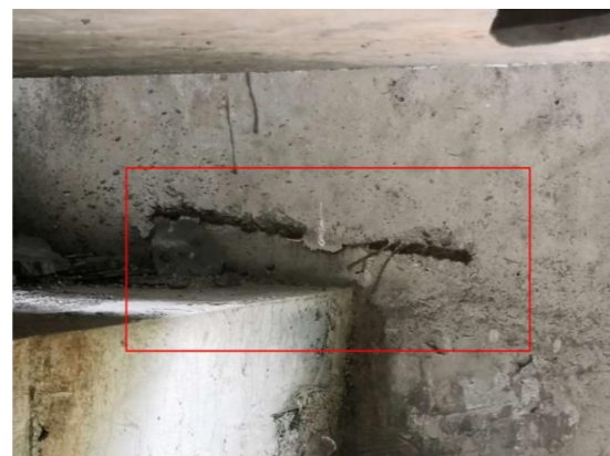
图 3-12: 斗米 3#大桥 (下行) GL-2D 盖梁: 距大桩号面 0m 处, 左侧挡块露筋; 数量: 1 处, 长度: 0.3m。
