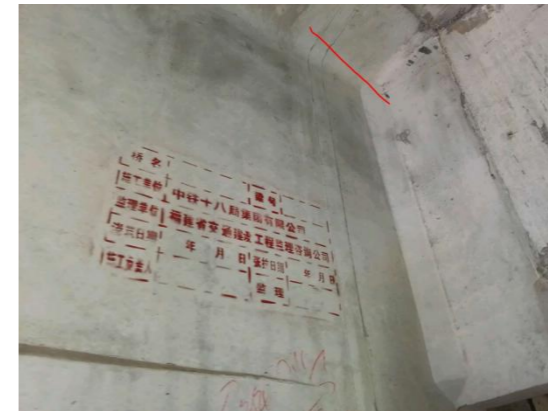
图 3-3: 和溪互通主线 1#桥(下行) 12-6T 梁: 距 12 号墩 0m 起, 左翼缘板斜向裂缝; 数量: 1 条, 长度: 1m, 宽度: 0.11mm。
