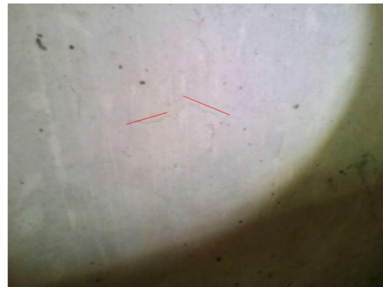
图 3-9: 永丰溪 1#大桥 (上行) GL-1D 盖梁: 大桩号面横向裂缝; 数量: 1 条, 长度: 0.1m, 宽度: 0.11mm。
