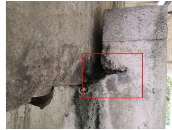
图 3-13: 和溪互通立交 2#桥 (上行) 左幅 GL-4D 盖梁: 右侧挡块破损; 数量: 1 处, 长度: 0.1m, 宽度: 0.1m。
