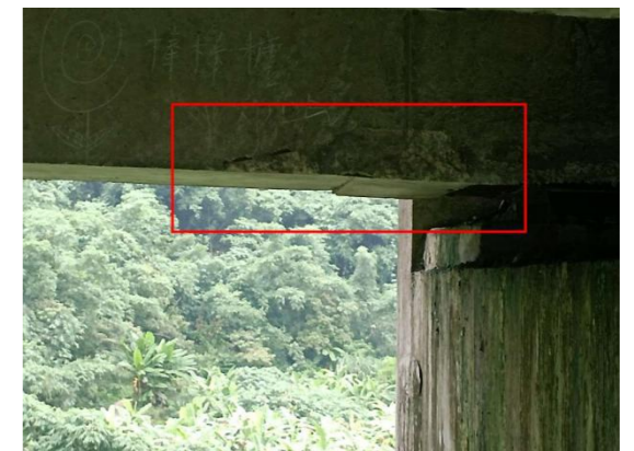
图 3-6: 后眷 1#大桥(上行)左幅 4-5T 梁: 距 4 号墩 0.3m 起, 马蹄右侧面破损露筋; 数量: 1 处, 长度: 0.5m, 宽度: 0.18m。
