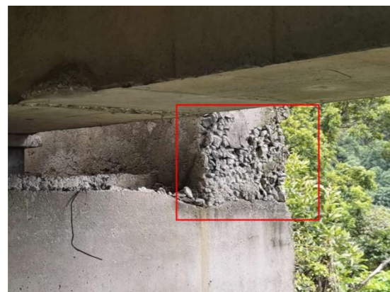
图 3-11: 斗米 3#大桥 (下行) GL-9D 盖梁: 右侧挡块蜂窝、麻面; 数量: 1 处, 长度: 0.3m, 宽度: 0.3m。
