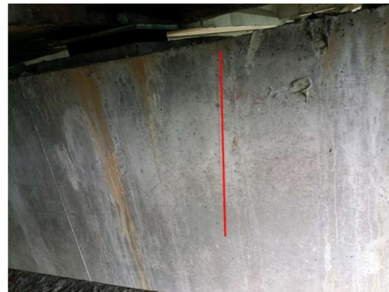
图 3-10: 后眷 3 号大桥 (下行) GL-2D 盖梁: 距右侧 1.5m 处, 距上缘 0m 起, 小桩号面竖向裂缝; 数量: 1 条, 长度: 0.1m, 宽度: 0.12mm。
