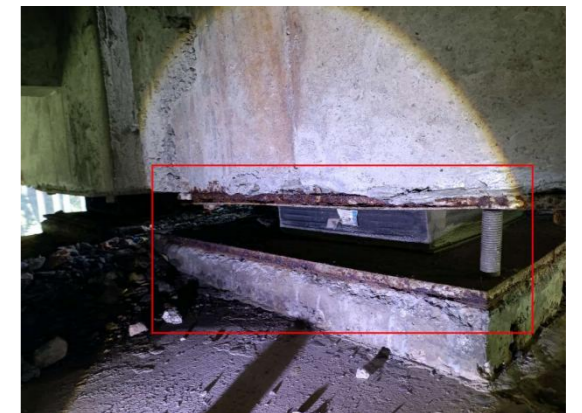
图 3-16: 南清大桥 (上行) 右幅 ZZ-8-7-5 支座: 大桩号面钢板锈蚀; 数量: 1 个。
