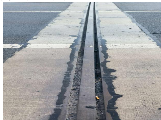
图 3-23 都美特大桥(下行) 9f 伸缩缝: 距左侧 0m 起, 伸缩缝橡胶条橡胶带老化破损; 数量: 1 处, 长度: 2m, 宽度: 0.1m。
