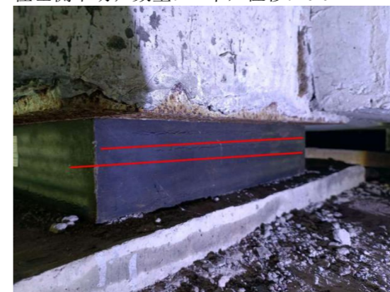
图 3-17: 南清大桥 (上行) 右幅 ZZ-8-8-5 支座: 小桩号面横向开裂; 数量: 3 条, 长度: 0.4m, 宽度: 0.18mm。
