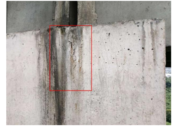
图 3-14: 后眷 4 号大桥 (下行) GL-3D 盖梁: 距小桩号面 0.5m 起, 距上缘 0.25m 处, 左侧挡块胀裂剥落; 数量: 1 处, 长度: 0.5m, 宽度: 0.15m。
