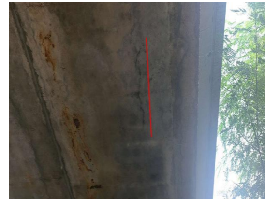
图 3-1: 盘古主线下穿桥 1-3 空心板: 距 1 号墩 10m 处, 板底纵向裂缝; 数量: 1 条, 长度: 0.5m, 宽度: 0.12mm。
